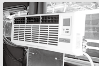
エアコンの室内機はハイエースの側面 に壁掛け設置。広い車内全体を均等に 冷やす方式にしている。
