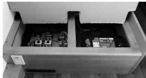
サブバッテリーの上には物を置かないように注意しよう。ショートするとヒューズが飛んだり最悪は火事になってしまう。
